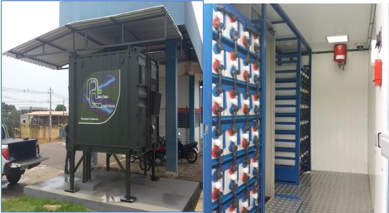
Figura 2. Datacenter Modular do Programa Amazônia Conectada.
