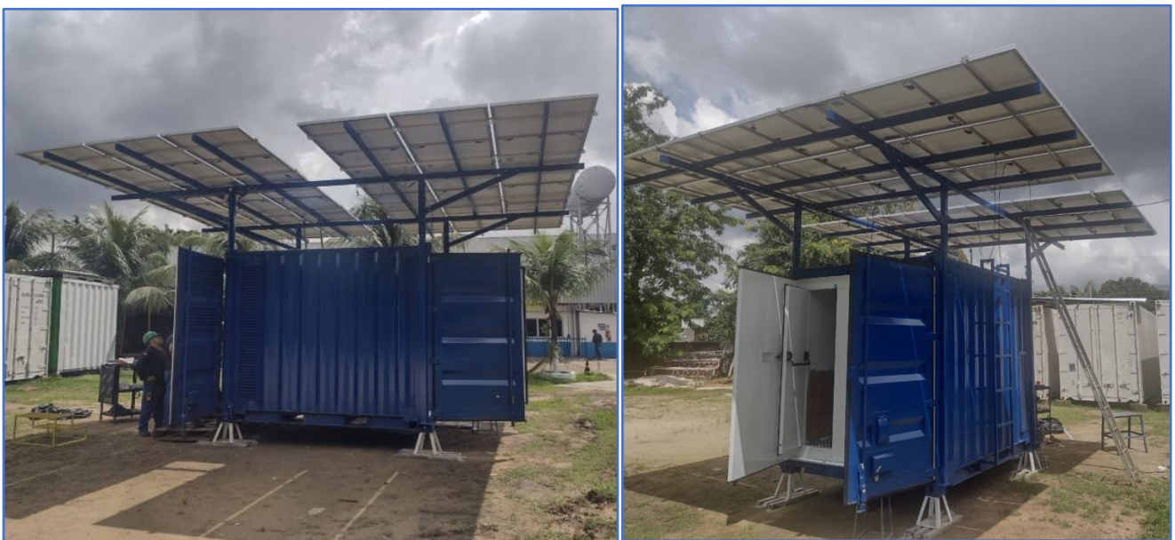
Figura 10. Placas fotovoltaicas no DCM.
