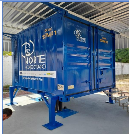
Figura 3. Datacenter Modular do Norte Conectado – Infovia 00.
