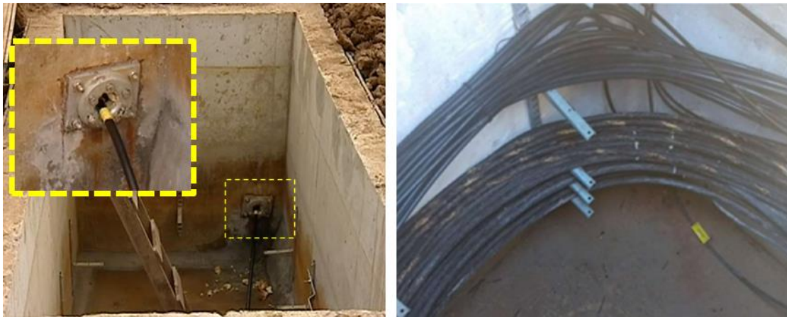
Figura 1. Imagens de uma caixa de ancoragem em fase de construção e reservas do cabo acomodados.
