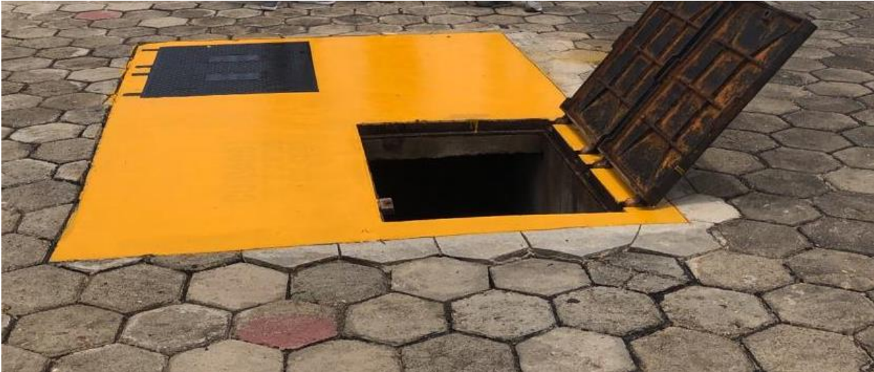
Figura 3. Infraestrutura externa de uma Caixa de Ancoragem – Infovia PAC, Novo Airão – novembro/2021.
