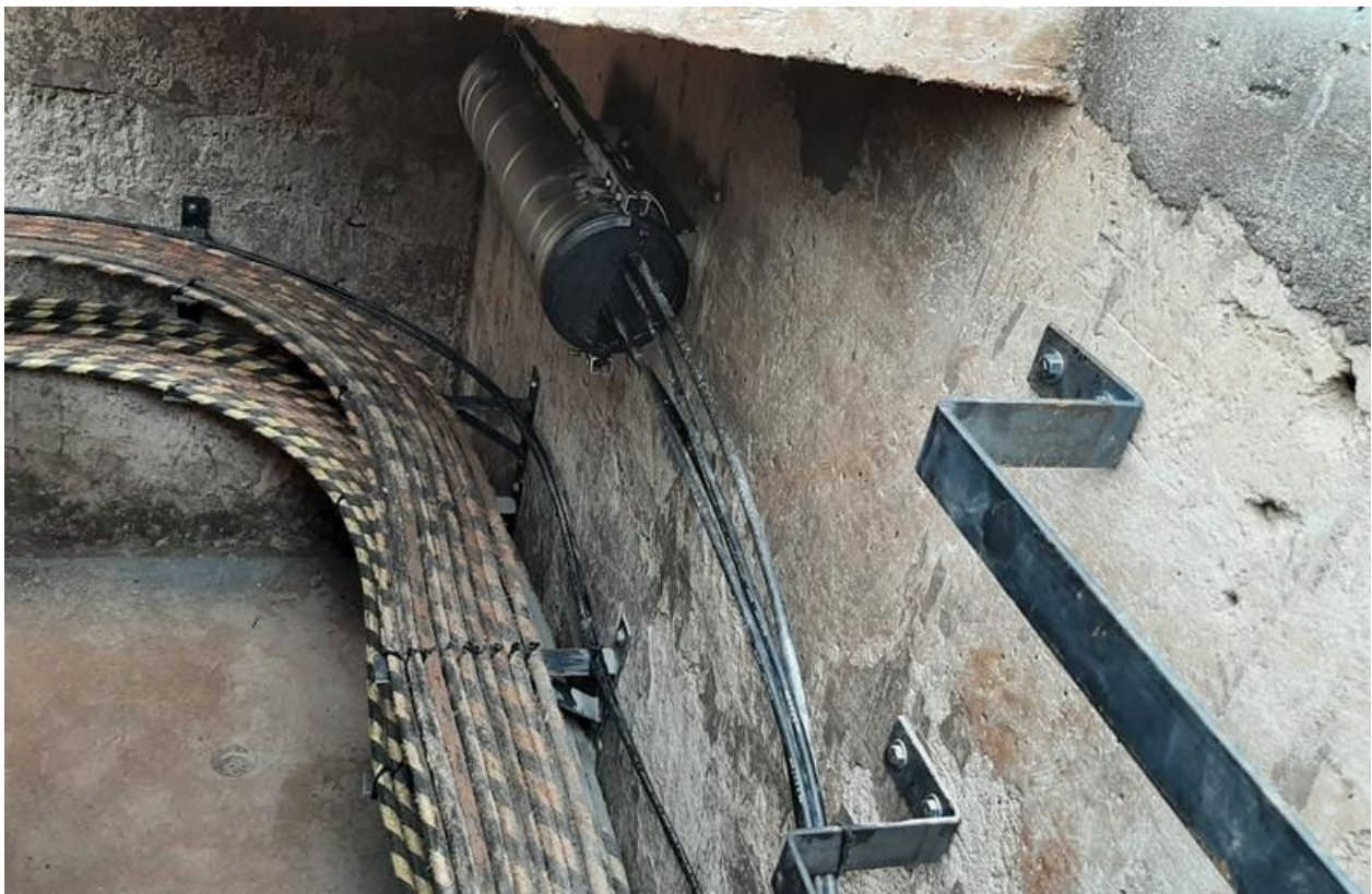
Figura 4. Infraestrutura interna da Caixa de Ancoragem com as acomodações do COS e cabo terrestre.
