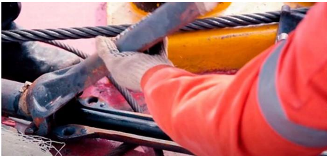
Figura 5. Imagens do elemento de infraestrutura de proteção de um cabo subaquático (“split pipe”).
