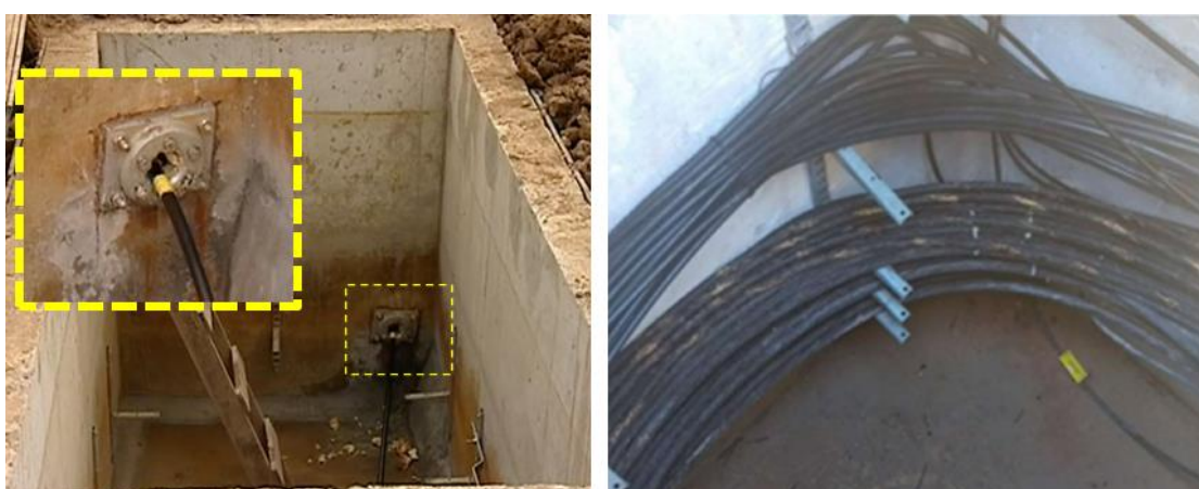
Figura 8. Imagens de uma caixa de ancoragem em fase de construção e reservas do cabo acomodados.
