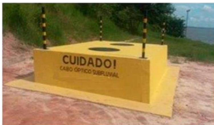
Figura 9. Imagem externa de uma caixa de ancoragem finalizada e identificada.
